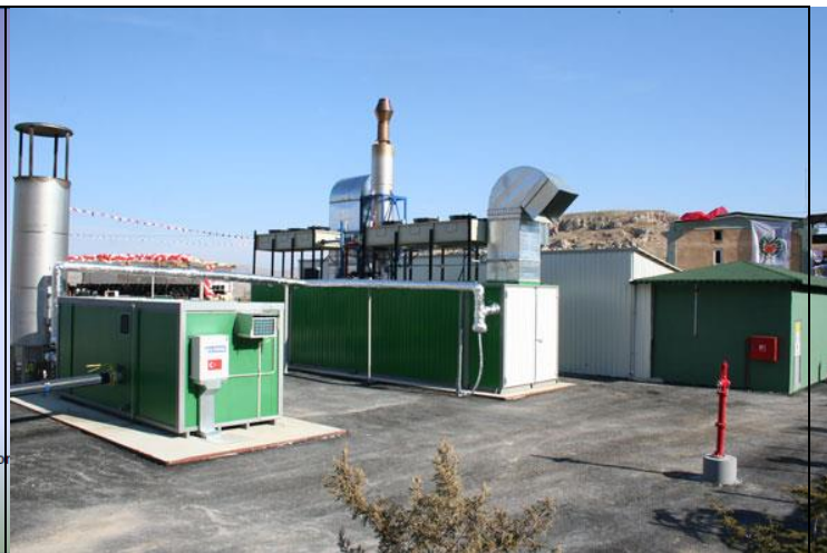
Şekil.5. Malatya katı atık kaynaklı elektrik üretim santrali
